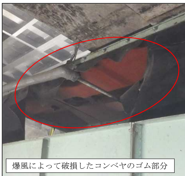
爆発によって損傷したコンベヤ
