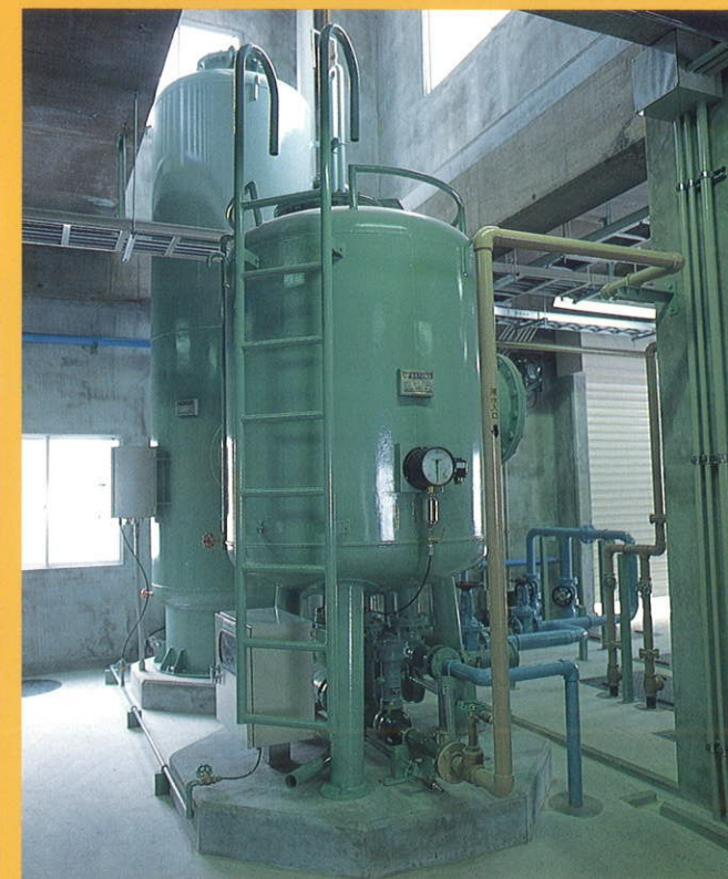
急速ろ過装置/活性炭吸着装置
